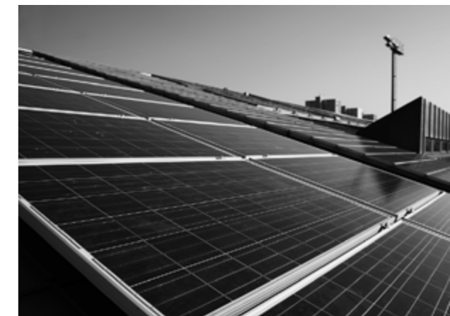
Photovoltaikanlage auf dem Stadionsdach des FC Solothurn
